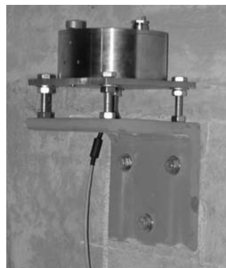
b) Inclinomètre dans son boîtier de retournement en station dans l'ouvrage
