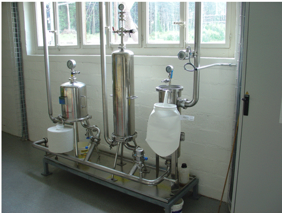
Abbildung 16: Feinfiltration mit - der Fließrichtung des Öls folgend - Beutelfilter (rechts), Kerzenfilter (Mitte) und Modulfilter (links).
