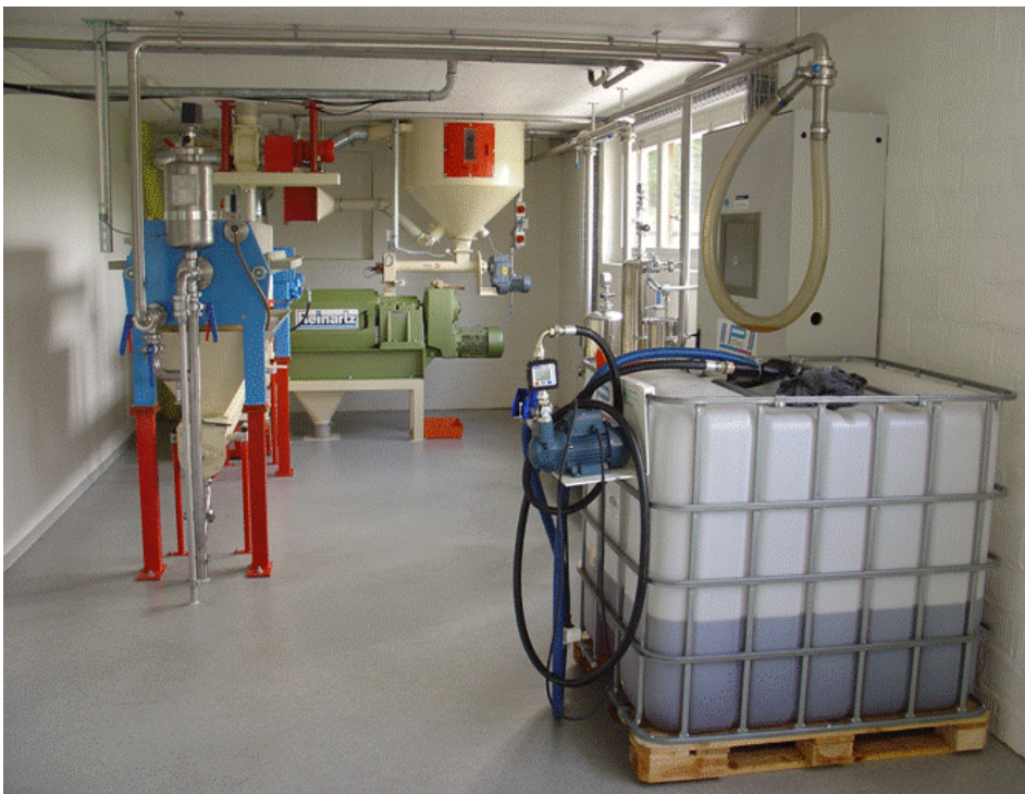
Abbildung 7: Die Kernelemente der Ölmühle im 1. OG: Kammerfilterpresse (links), Rapspresse und Pressenspeisung (hinten), IBC-Container mit Pumpe, Steuerschrank und Feinfilter (rechts).
