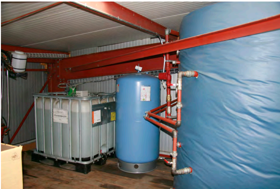
Abbildung 119: Harnstofftank (links), Jenni-Heizungsspeicher (rechts) und Expansionsgefäß (mitte).
