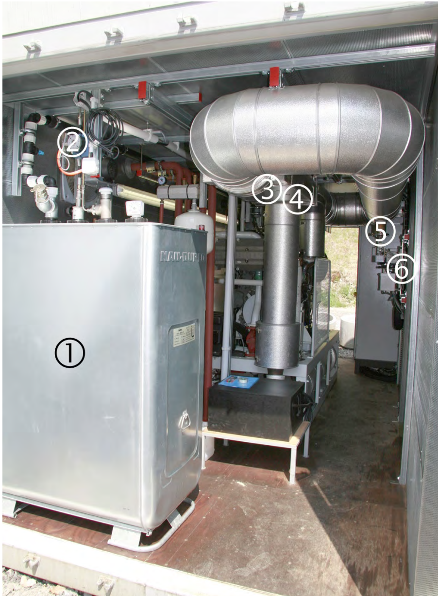
Abbildung 113: Blick auf Tagestank 1; Zusatzförderpumpe für Pflanzenöl 2; Partikelfilter 3; SCR-Katalysator 4 und Harnstoffinjektion vor Mischstrecke 5.
