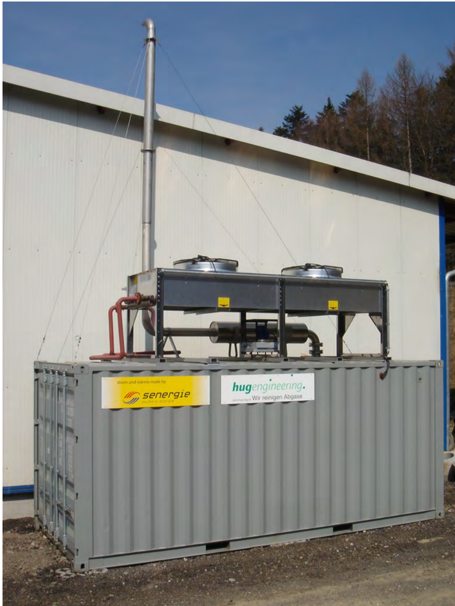
Abbildung 111: Das Pflanzenöl-BHKW im 20-Fuss ISO-Container in Suberg, mit Notkühlaggregaten und Rapsölkraftstoffkühler auf dem Dach.
