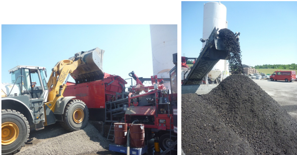
Abbildung 7: Mobile Kaltmischanlage N1/N7 (Typ KMA 220, Wirtgen, Tagesleistung bis 2200 t pro Anlage).
