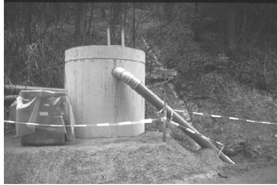
Bild A6.10: Abscheider am Ufer der Lorze
