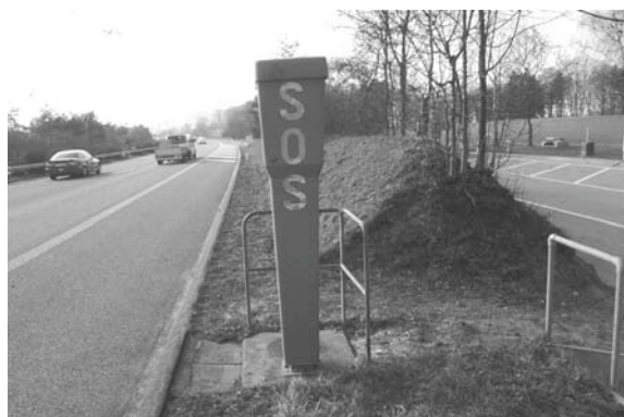
Bild 10: Gefährlicher Unterbruch eines Schutzwalls am Aussenrand einer Autobahn
