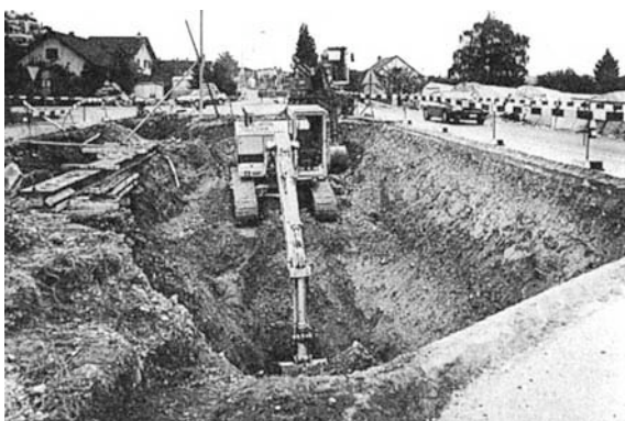
Bild A1.3: Grossvolumige Kontamination beim Sickerschacht am Ortsrand
