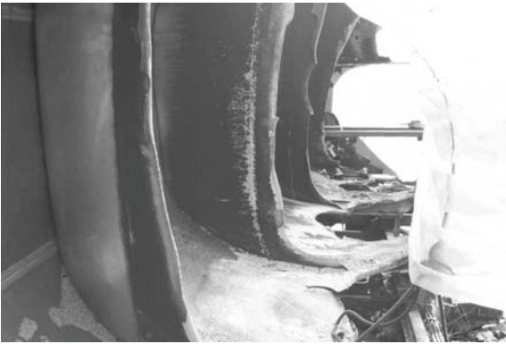
Bild A7.7: Verbrannte Schwallwände im Transporttank
