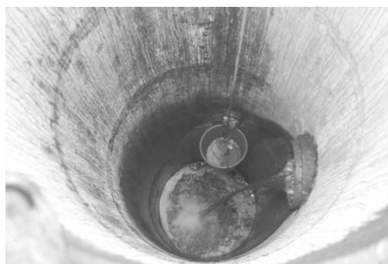
Bild A6.8: Kontrollschacht mit infiltriertem Wasser-Benzin-Gemisch
