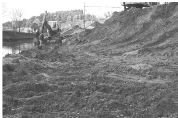
Bild A2.7: Grossflächiger Abtrag der Böschung
