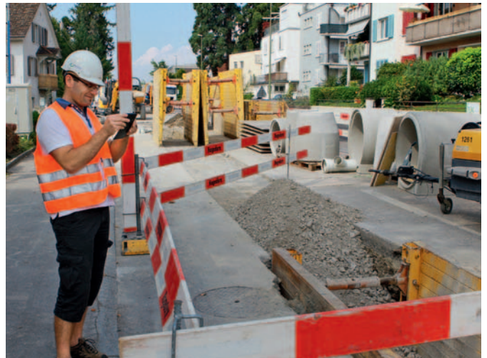
7 | Die Kursteilnehmenden übersehen nichts: Mangelhafte Ausführungen werden auf Fotos festgehalten und anschliessend im Plenum diskutiert.
