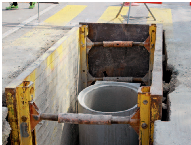
9 | Kein Musterbeispiel für eine gut ausgeführte Spriessung. Die Hinterfüllung ist mangelhaft. 9 | Mauvais exemple d'étayage bien réalisé. Le remplissage est mauvais (photos: Rolf Leeb).
