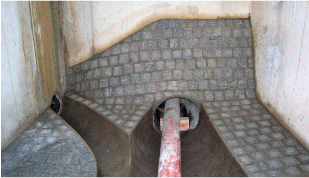
10 | Granitpflasterungen der Sohle und Verkleidungen in den Schächten verringern die Abrasions- und Kavitationsschäden am Beton (Foto: Moritz Wildi).
