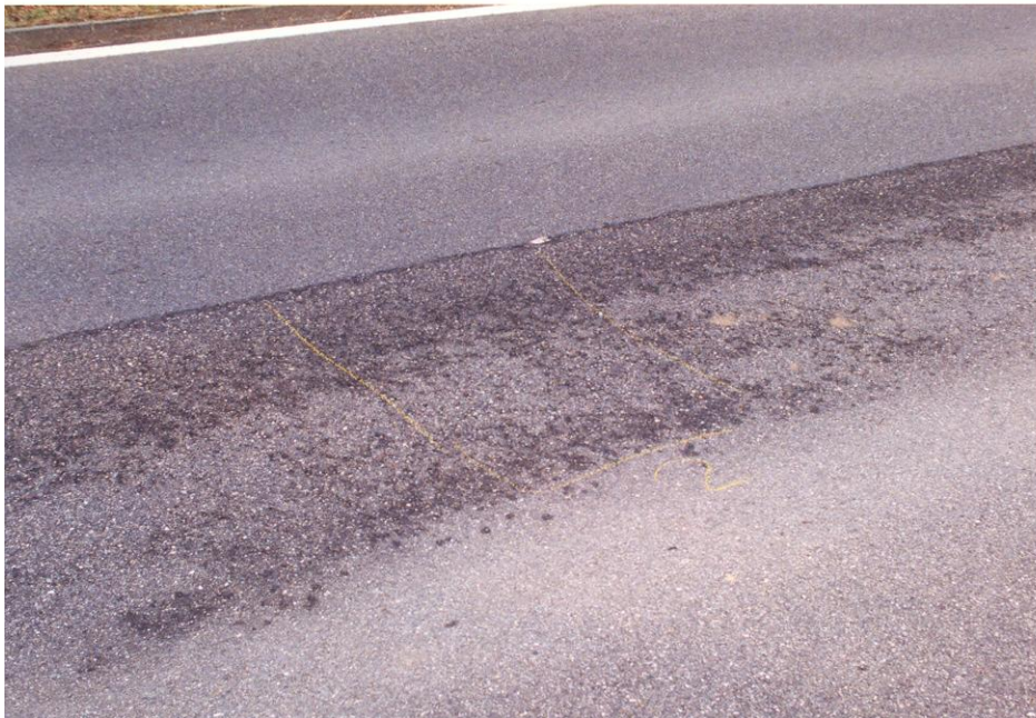
Abbildung 8: Unten: Belag mit Kornausbruch, oben: intakte Gegenfahrbahn
