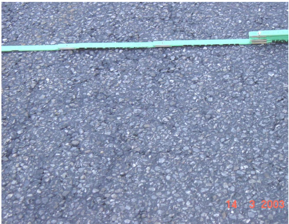
Abbildung 24: Risse in der Deckschicht des Objektes UR1
