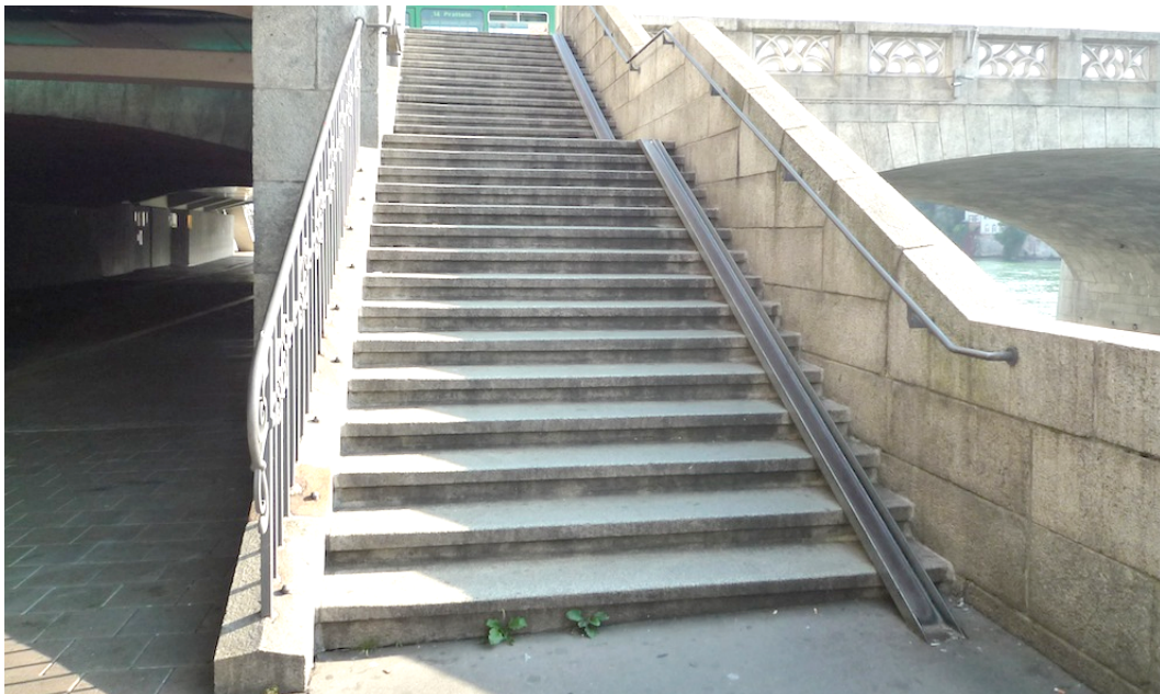
Abbildung 40 Nachträglich angeordnete Schieberille für Velos, Basel, Mittlere Brücke
