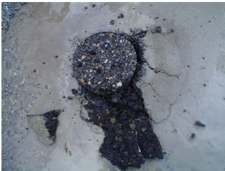
Abbildung 5.4.3: Während der Bohrkernentnahme zerbröckelter Belag
