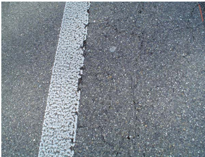
Abbildung 5.4.2: Belag A1 mit Rissen und Ausbrüchen, besonders im Bereich der Radspuren
