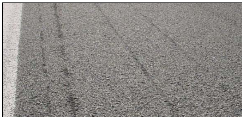
Abbildung 4: Beispiel für mechanische Schäden an Offenerporigen Asphaltdeckschichten durch Radfelgen
