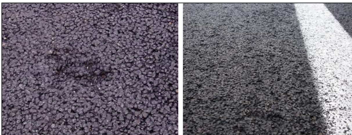
Abbildung 3: Beispiele für Kornausbrüche an Offenporigen Asphaltdeckschichten
