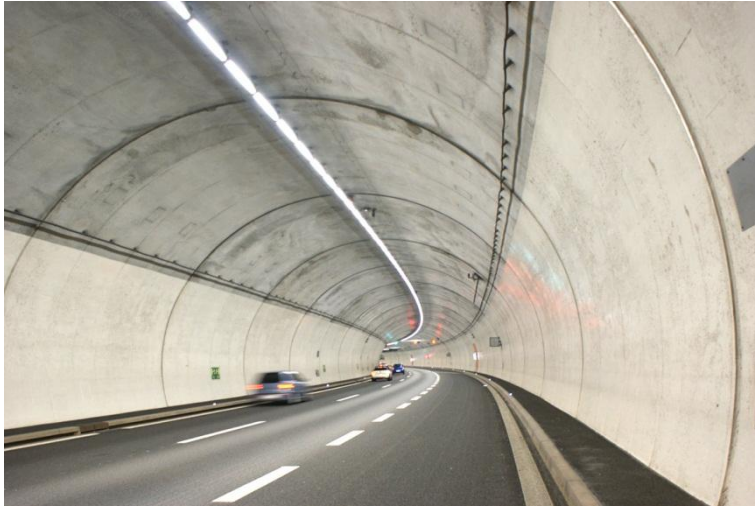
Abb. XI.29 Linienbeleuchtung, Westumfahrung Zürich
