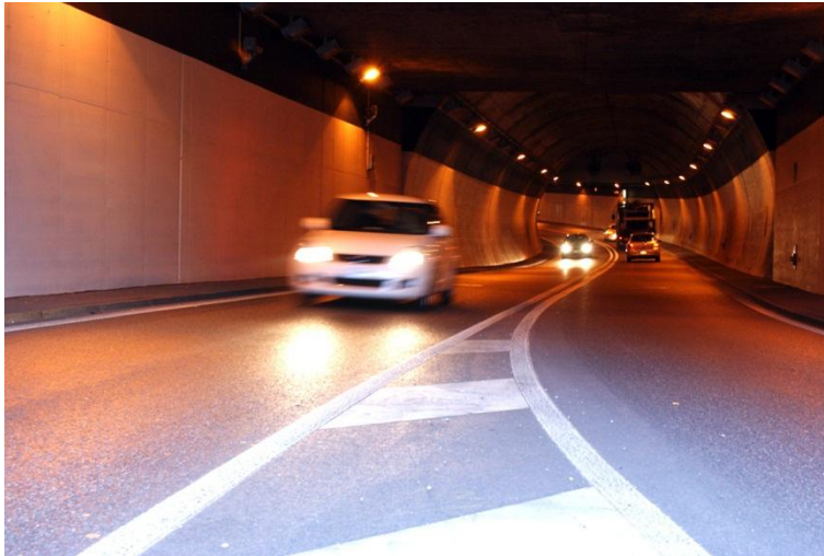
Abb. XI.33 Seitliche Punktleuchten, Aarau
