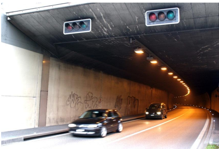
Abb. XI.31 Punktbeleuchtung in Tunnel mit Gegenverkehr
