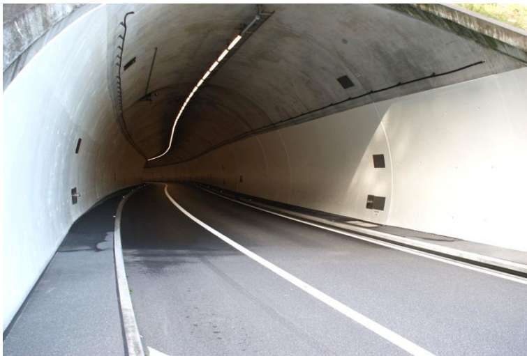
Abb. XI.30 Linienbeleuchtung in Tunnel mit Gegenverkehr
