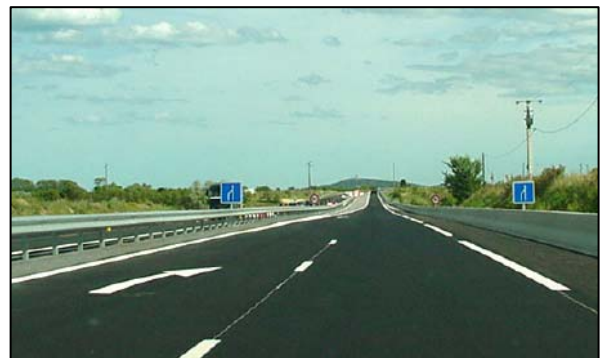
Figure 20 : Exemple de cohérence le long du tracé de la route par un changement du profil en travers traité correctement [8]
