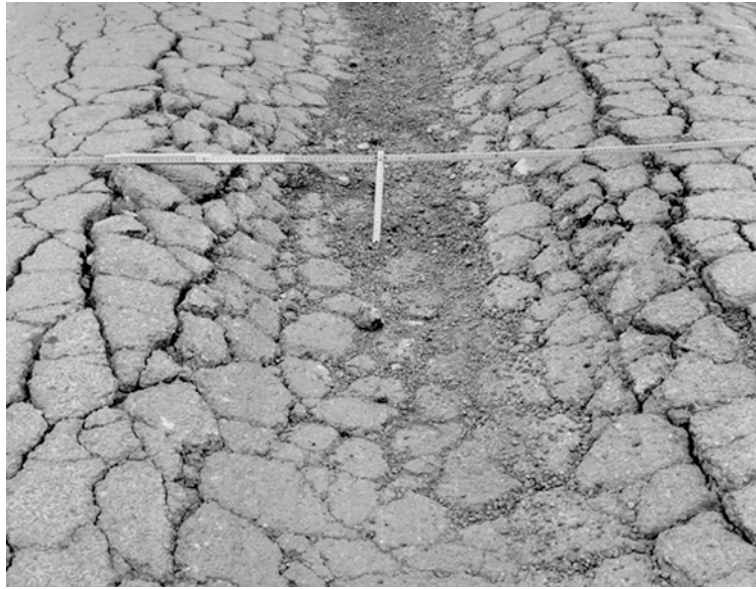
2-16 Poinçonnement d'une route lors du dégel (hiver 1962-63)
