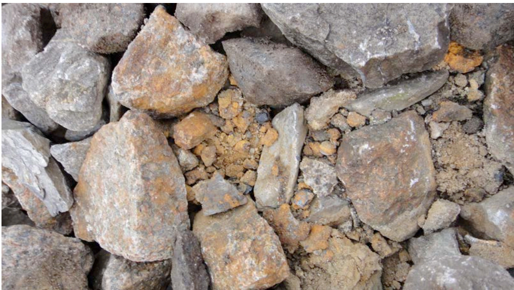
Fig. 133.10 Exemple d'un lit de ballast pour voies ferrées comportant une forte proportion de grains sensibles aux effets des intempéries. Cette voie nécessite un renouvellement prématuré du ballast dû à l'altération des granulats. Examens de la voie et photographie M. Erich Würsch, CFF – Infrastructure. Les essais en laboratoire avec la nouvelle méthode permettent de reproduire ces types de dégradations.
