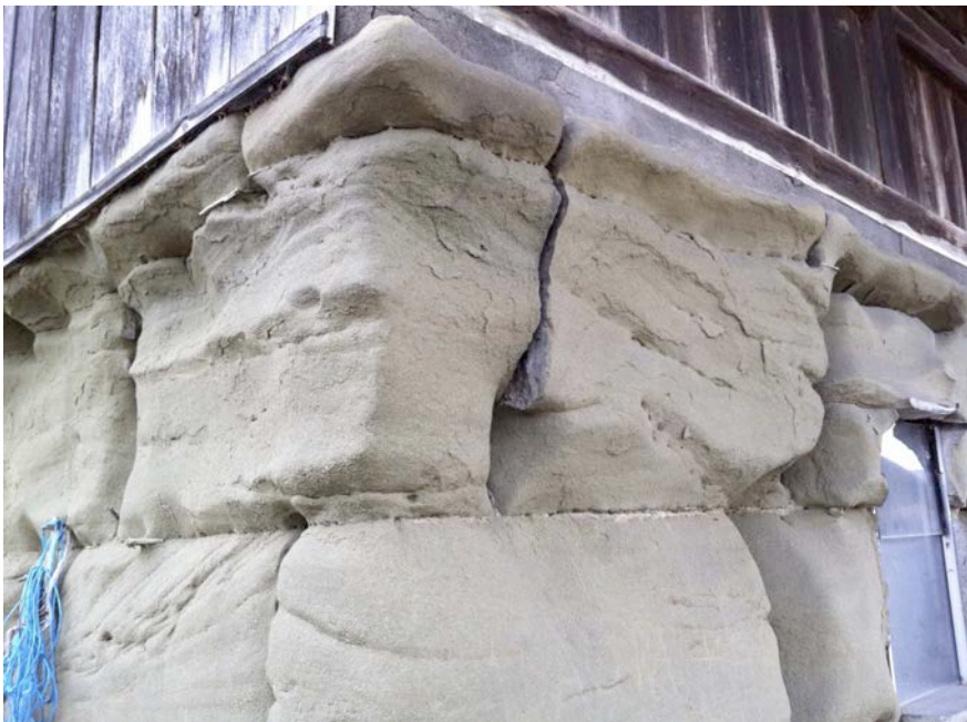
Fig. 133.13 Blocs de grès molassique bernois dans un bâtiment de la région de Krauchtal dans le canton de Berne. L'altération se présente sous forme de pelure d'oignon et d'effritement.
