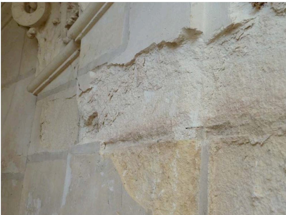
Fig. 133.6 Dégradation d'une paroi dans un château en tuffeau ou pierre de Bourré dans le Val de Loire. Ici aussi les dégradations correspondent aux phénomènes qui peuvent être reproduits en laboratoire.
