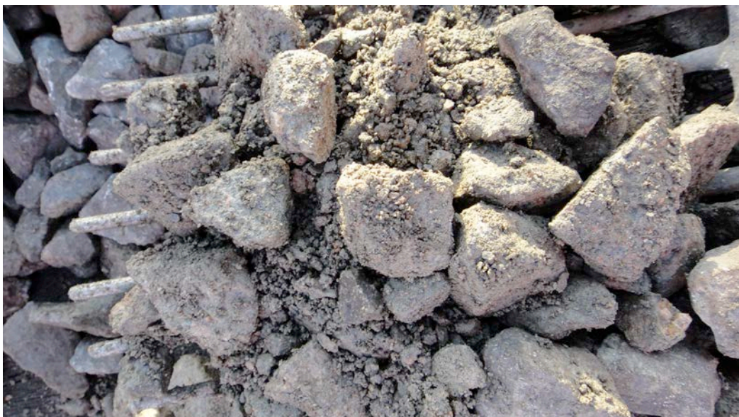
Fig. 133.8 Exemple d'un ballast pour voies ferrées en Suisse nécessitant un renouvellement prématuré dû à l'altération des granulats composés de granite chloritisé et kaolinisé. Examens de la voie et photographie M. Erich Würsch, CFF – Infrastructure.
