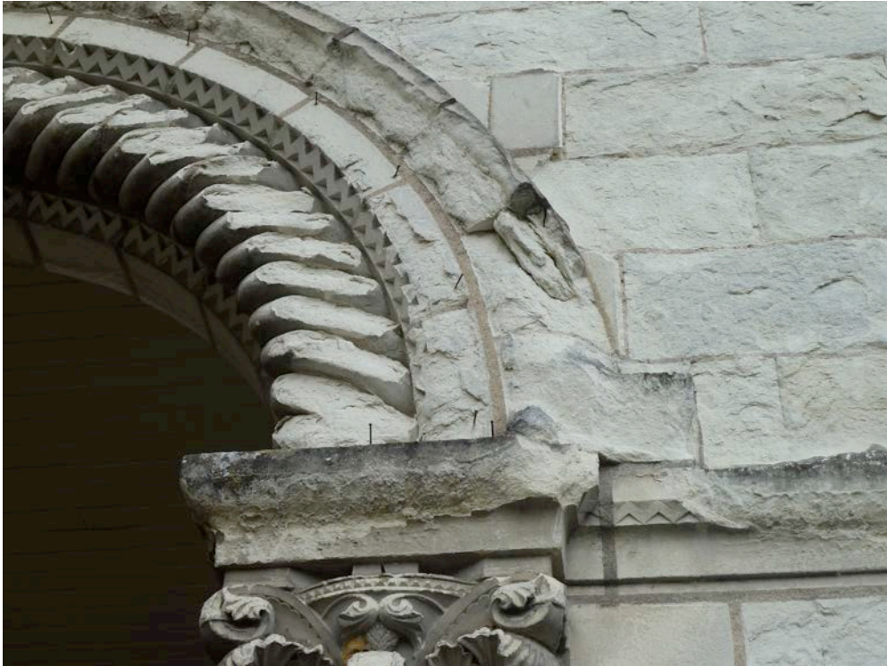
Fig. 133.5 Dégradation d'un bâtiment historique en tuffeau ou pierre de Bourré dans la région de Montrichard dans le Val de Loire. Les phénomènes observés in situ correspondent aux dégradations reproduites en laboratoire.
