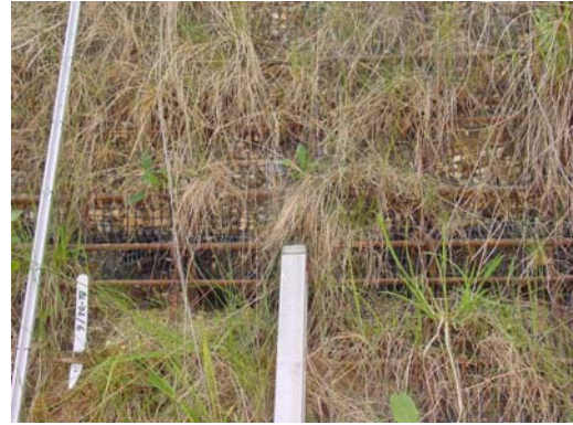
Abb. 5.72: Mäuseschäden II In einem Stoss der Stützgitterelemente haben die Mäuse eine Galerie ausgeräumt (BL-02, 27.04.2011/BST)
