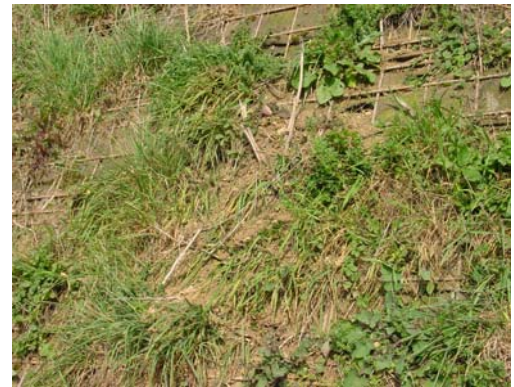
Abb. 5.74: Mäuseschäden IV Das ausgeschobene Material bleibt an unten wachsenden Grashorsten hängen (AG-11, 14.10.2008/BST)
