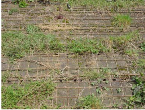
Abb. 5.71: Mäuseschäden I Horizontaler Mäusegang mit Auswürflöchern für das gegrabene Material (AG-11, 14.10.2008/BST)
