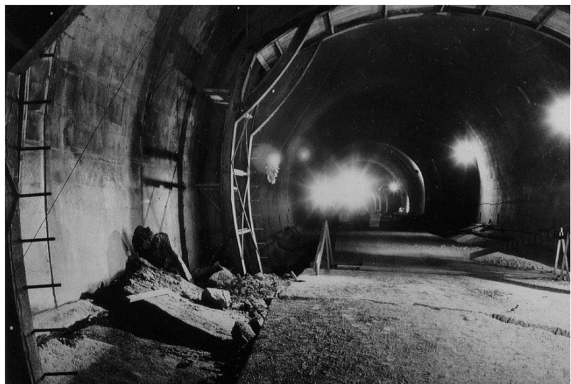
Bild 3-20 Belchentunnel: Im Übergangsbereich zum Parament aufgestauchtes, unbewehrtes Sohlgewölbe von 45 cm Stärke (links). In der rechten Bildhälfte ist der in Platten zerbrochene Füllbeton zu sehen (Archivfoto, Kant. Tiefbauamt, Basel-Land).
