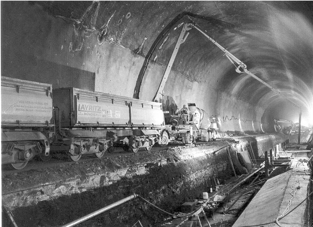
Bild 6-6 Freudensteintunnel: Betriebsweise mit grosser Ringschlusszeit der Aussenschale. Bauzustand nach dem Einbau der Betonschulter (rechts im Bild) und des rechten Sohlgewölbeteils der Aussenschale (Klonsdorf und Schaser, 1991)
