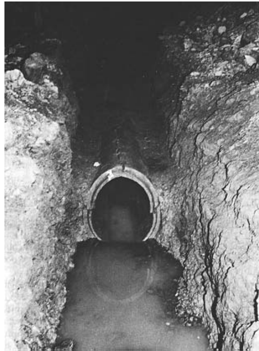
Bild 5-23 Belchentunnel: seitlich zusammengedrückte Entwässerungsleitung (nach Grob, 1972)
