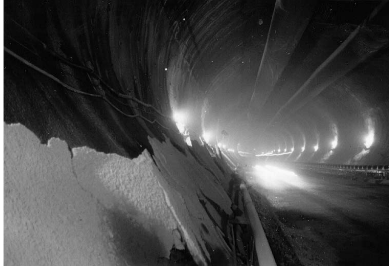
Bild 3-31 Engelberg-Basistunnel: Abscheren der Aussenschale im Ulmbereich durch Quelldruck auf die Spritzbetonschale. Anheben der Tunnelsohle vor dem Einbau der Innenschale (Rock und Schömig, 1999).
