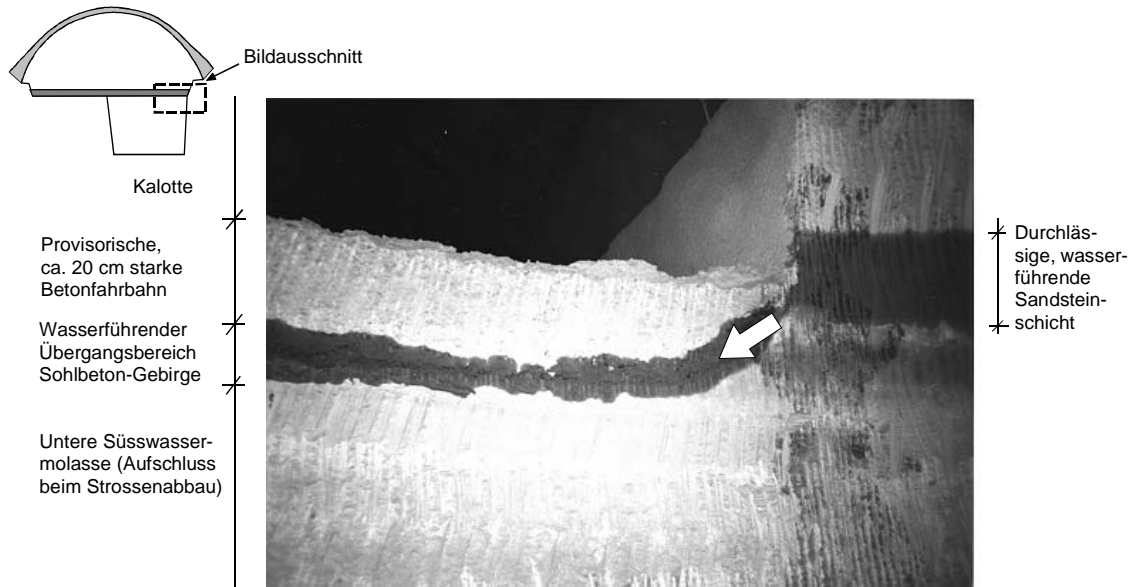
Bild 4-3 Tunnel Birchi: Wasserzufluss aus einer durchlässigen, wasserführenden Sandsteinschicht (rechts im Bild) in die Kontaktzone zwischen Betonfahrbahn und quellfähigem Fels. Deutlich erkennbar sind die dunklen, wasserführenden Gebirgsbereiche (Foto IGT, ETHZ, 1996).
