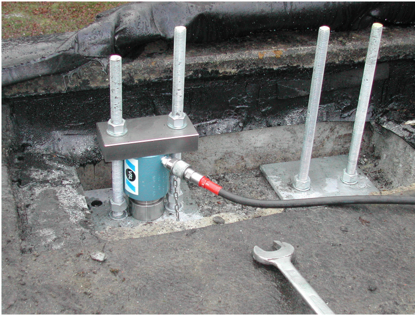
Abbildung 47: Bewegliche Verankerung auf dem Dach
