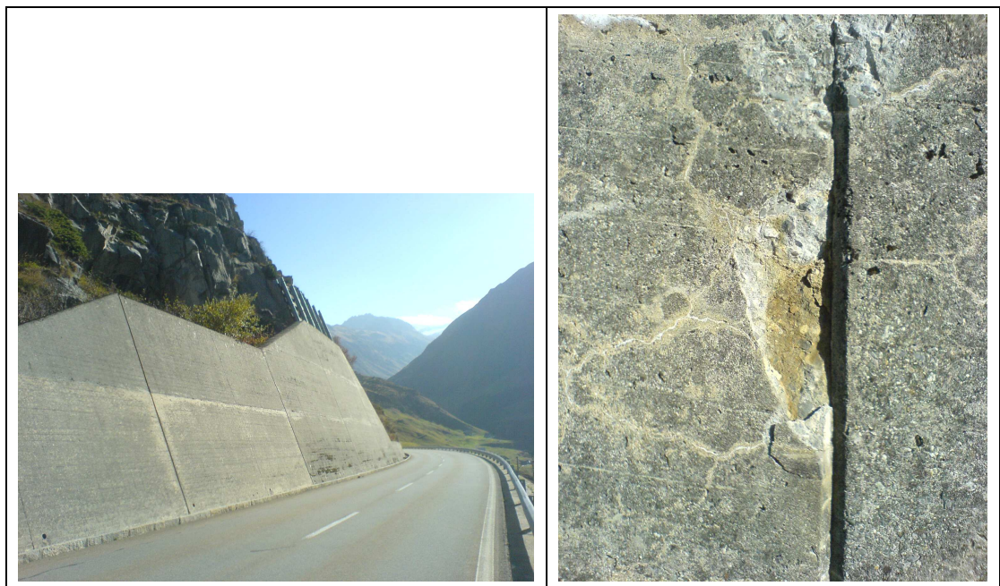
Abb. 1.1 Beispiel einer Stützmauer mit Anzeichen einer Alkali-Aggregat-Reaktion und leichten AAR-Schäden.
