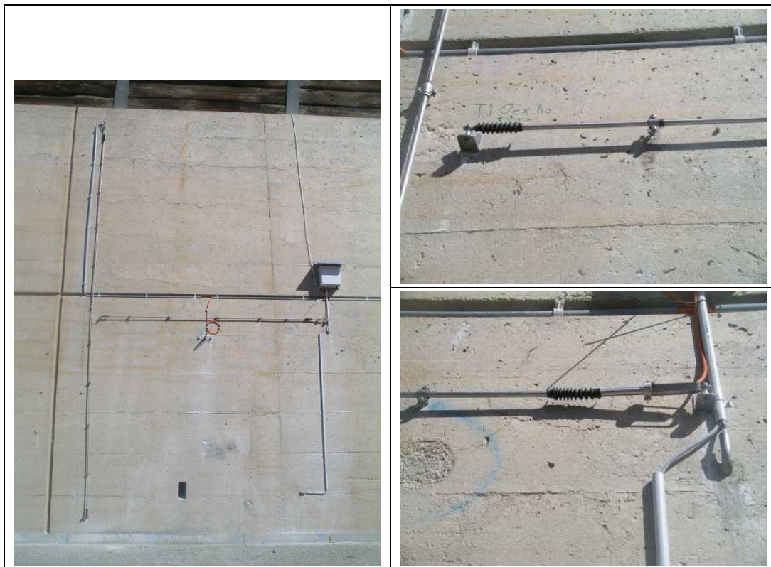
Abb. 2.8 Konventionelles Extensometer (Solexperts AG) am Beispiel der Installation am Objekt S7051 an der Simplonstrasse (siehe Kapitel 3.1).
