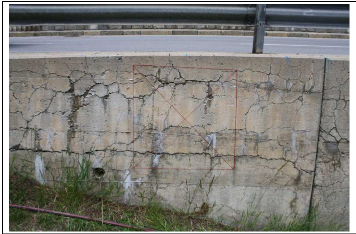
Abb. 3.10 Rissbreitenindex-Feld A: Bereich mit vielen Rissen an der Oberfläche.
