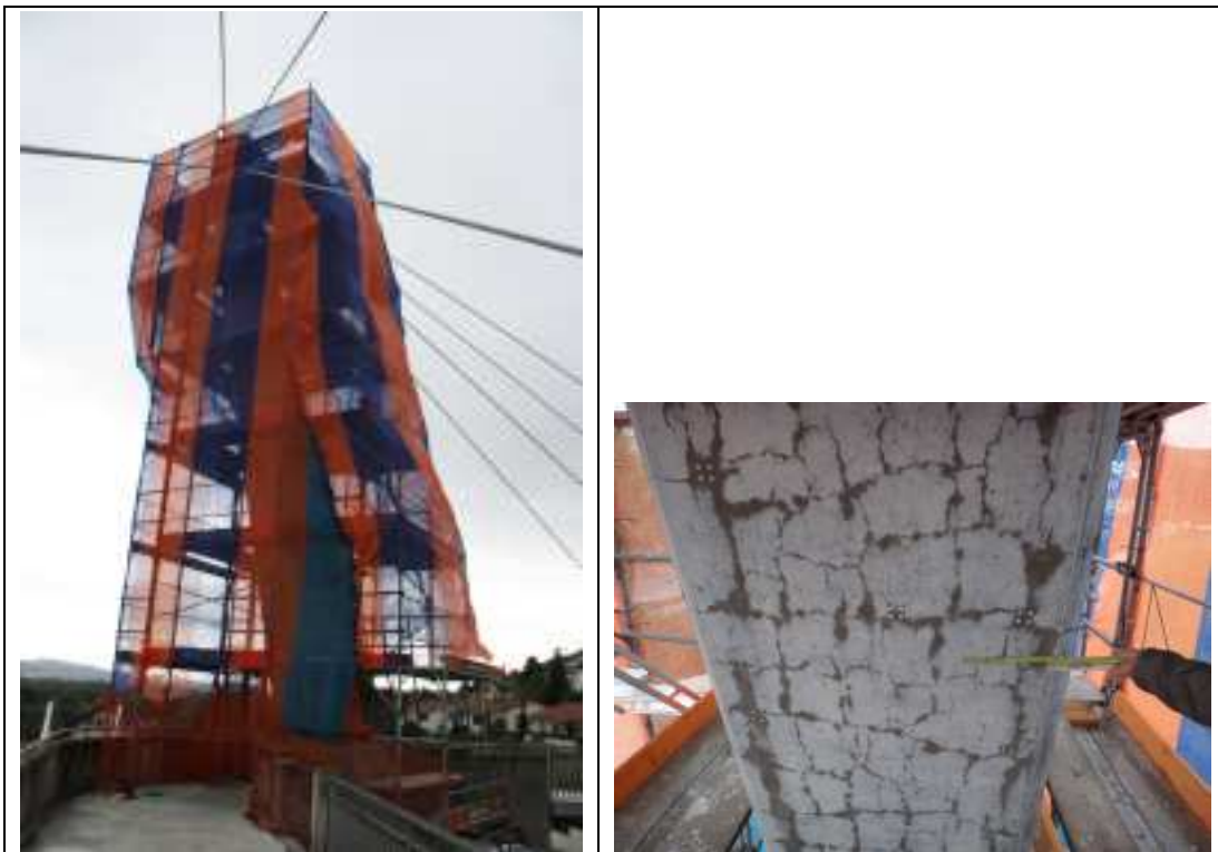
Abb. 3.21 Links: Eingerüsteter Pylon Rechts: Der Ausschnitt zeigt die gut erkennbaren (feuchten) Risse nach der Reinigung.
