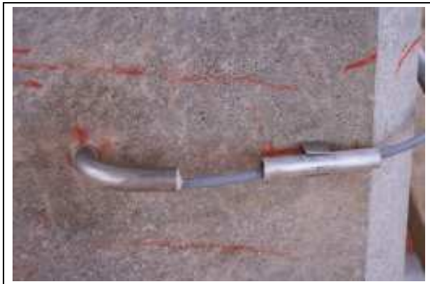
Abb. 3.22 Eingebauter Feuchtesensor Typ CS-322 der Corsensys AG. Details zum Aufbau: siehe Abb. 3.15 .
