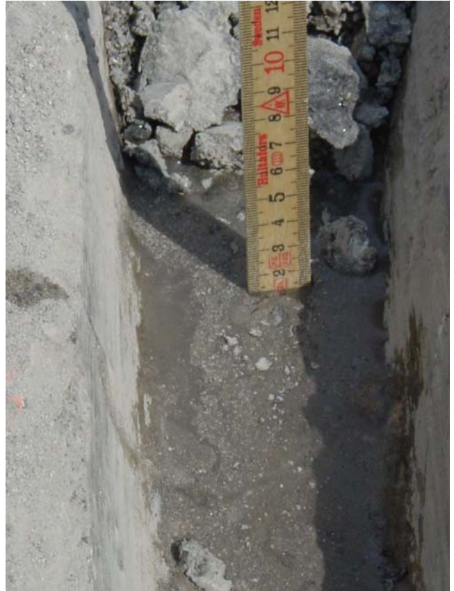
Abbildung 10.2.16: Wasser im Belagsschlitz
