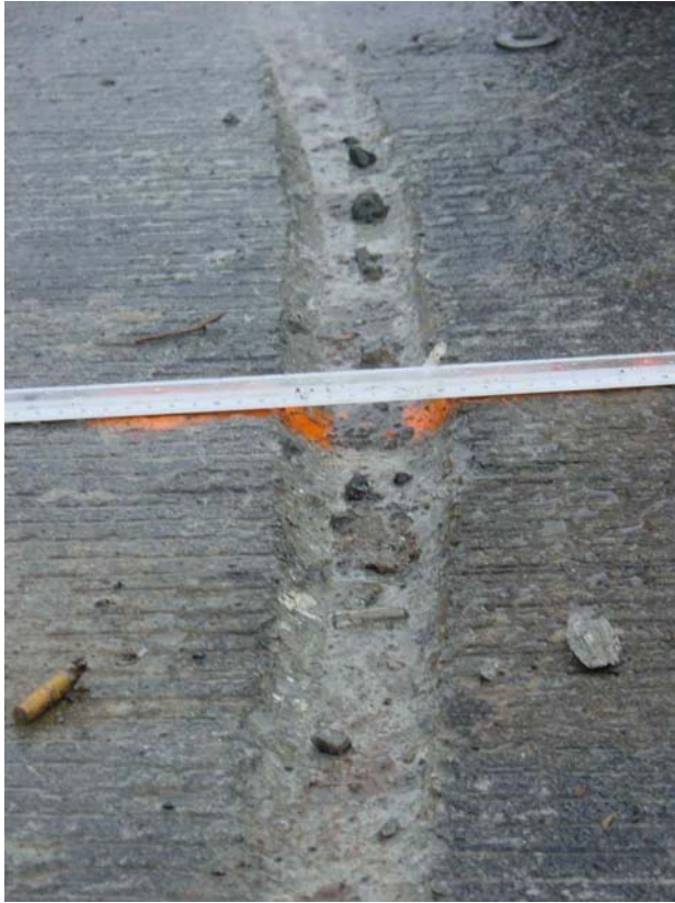
Abbildung 10.2.15: durch Baggerzahn abgetragener Beton
