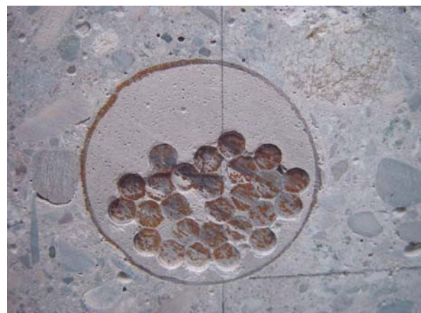
Abbildung 14: Durchgetrenntes Spannmitglied am Trägerende, sichtbar sind die 26 Drähte, das Injektionsgut und das Hüllrohr (Träger 1)
