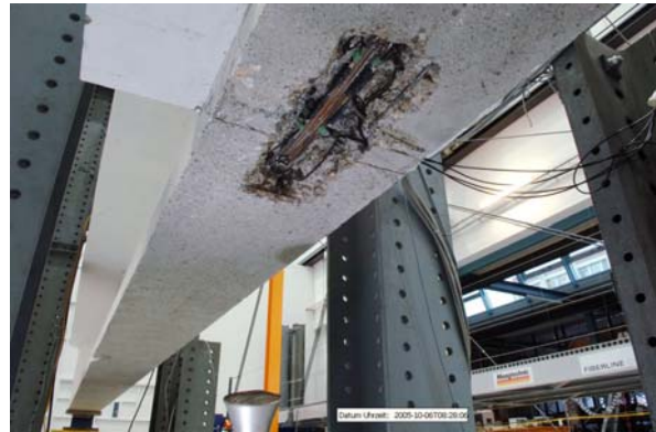
Abbildung 86: Untersicht des Trägers 5, Betonöffnung mit geschädigtem Spannglied
