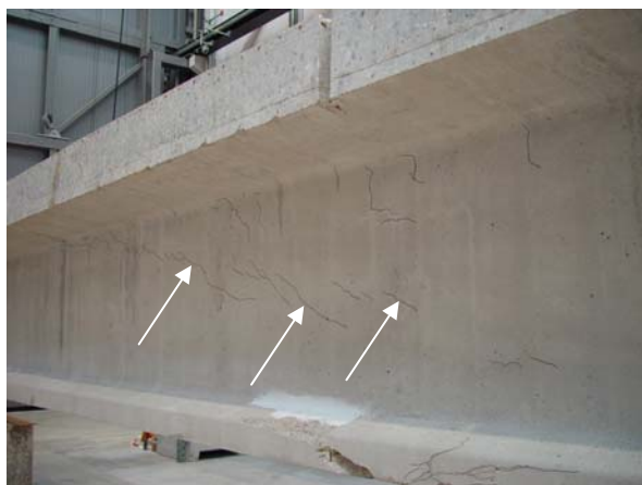
Abbildung 9: Risse im Steg beim Träger 5
