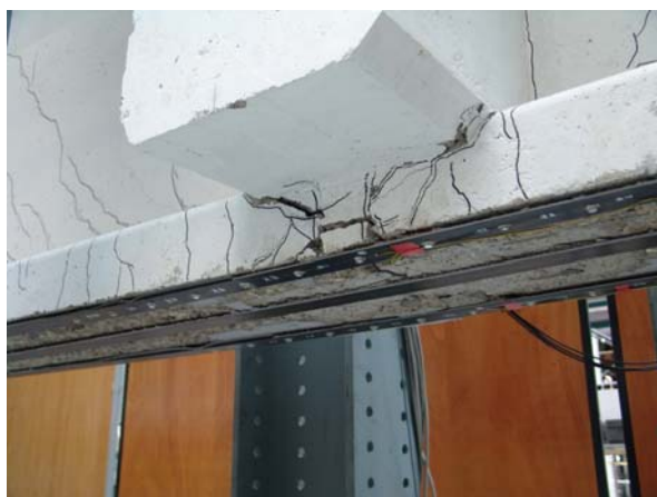
Abbildung 125: Die drei stabil delaminierten langen CFK-Lamellen
