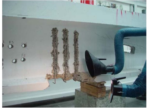
Abbildung 21: Herausspitzten der Bügelbewehrung
