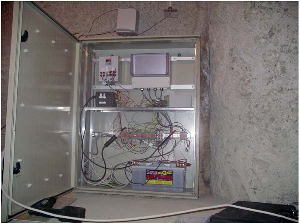
Bild 4.2: Messaufbau für die kontinuierliche Widerstandsmessung. Oben links Timer und Relaissteuerung; oben rechts Datenlogger; Mitte links umgebautes Metriso Messgerät, Mitte rechts Mehrkanalumschalter.
