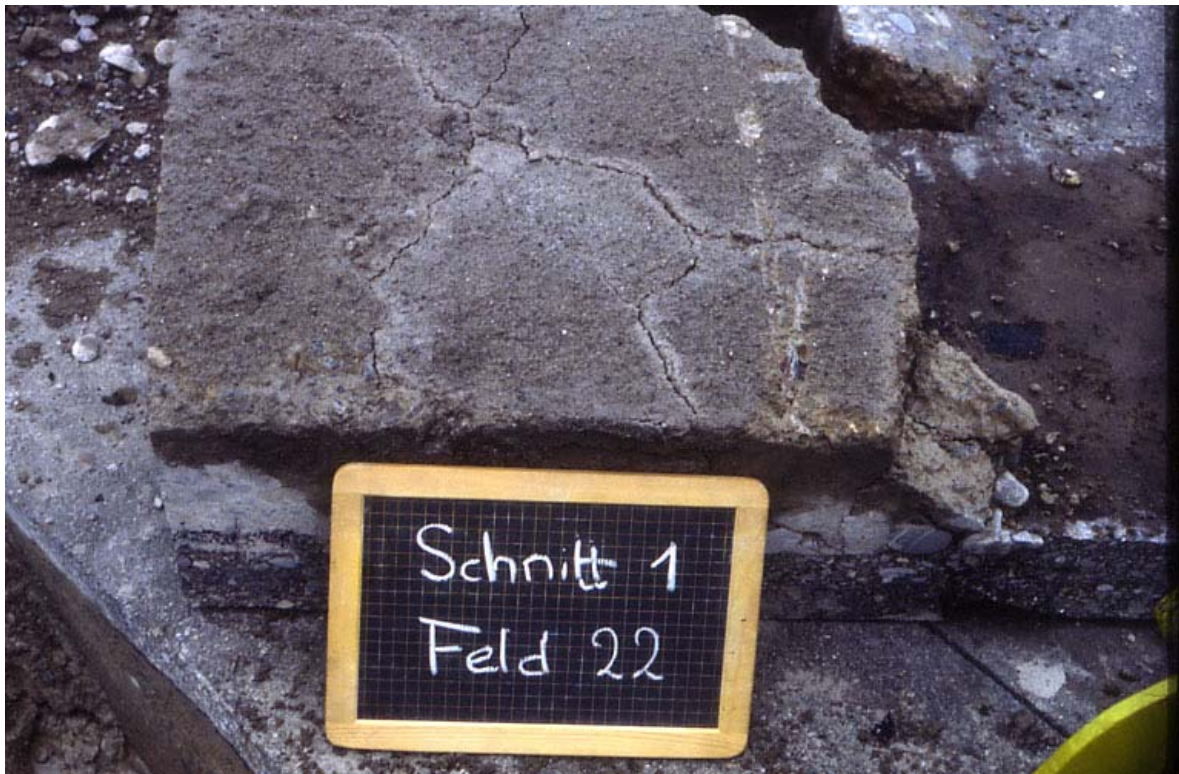
Abb. 77: Rundlauf, Versuch Nr. 2: Gerissene Unterseite der zementstabilisierten Schicht von Feld 22 (Schichtdicke der Zementstabilisierung = 150 mm, Belagsdicke 80 mm); die ursprünglich als durchgehende halbstarre Platte vorhandene Schicht ist in einzelne Bruchstücke zerfallen; damit ist ein Verlust der lastverteilenden Plattenwirkung verbunden [83].
