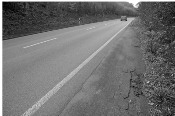
Bild 18: Typischer Schaden am Belagsrand
