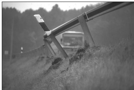
Fig. 21 : Glissières avec un encastrement insuffisamment rigide dans une banquette étroite
