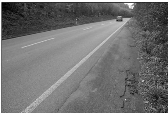
Fig. 18 : Dégâts typiques au bord du revêtement
