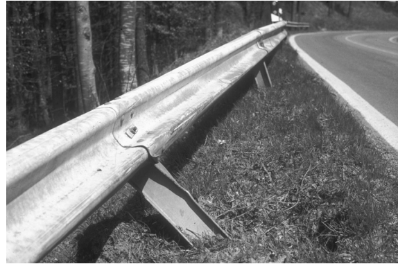
Bild 22: Leitschranke mit ungenügender Einspannung im Oberboden einer Böschung
