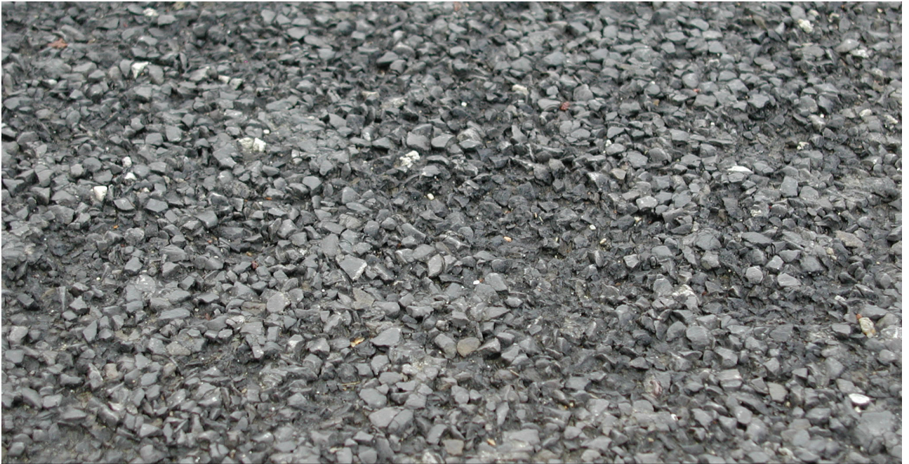
Fig. 11.5 : route cantonale n° 70 dans l'agglomération d'Avully. Enrobé de type MR 11 fortement dégradé peu après sa mise en service.
