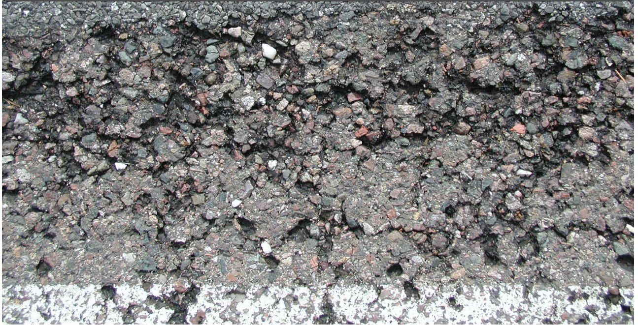
Fig. 11.3 : route cantonale RJ 18 près de la Chaux d'Abel dans le canton de Berne. Restes d'enrobé rouge de type AB 11 L posé en 1997 et totalement dégradé en 2002. Le mastic présente de graves dégradations. Les granulats par contre sont intacts.
