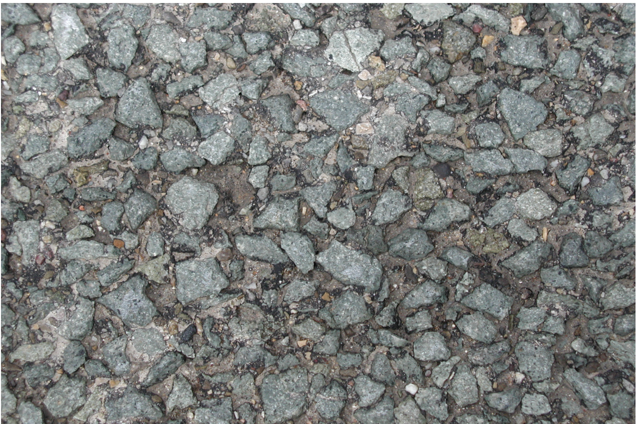
Fig. 11.6 : route cantonale Saint-Ursanne les Rangiers. Dégradation du mastic dans le MR 11 composé de rhyodacite. Les granulats restent intacts et seul le mastic est dégradé.
