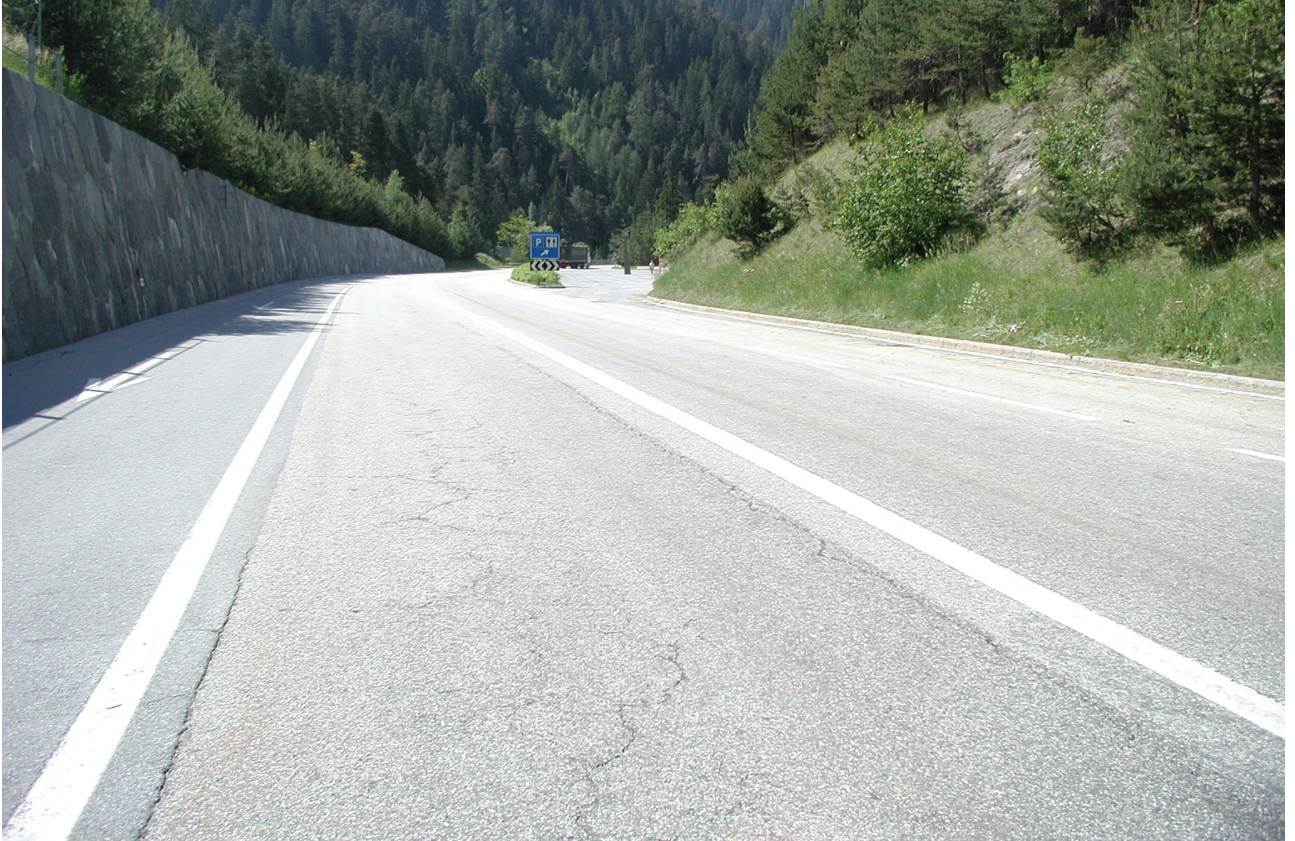
Fig. 11.10: revêtement de type AB 10 ou AB 16 de la route du col du Simplon à la hauteur du "Gunzigrabenbrücke dans la voie montante. L'âge du revêtement se situe entre 20 et 25 ans. Peu de dégradations sont visibles dans le mastic mis à part des zones qui présentent par endroits de fortes fissurations.
