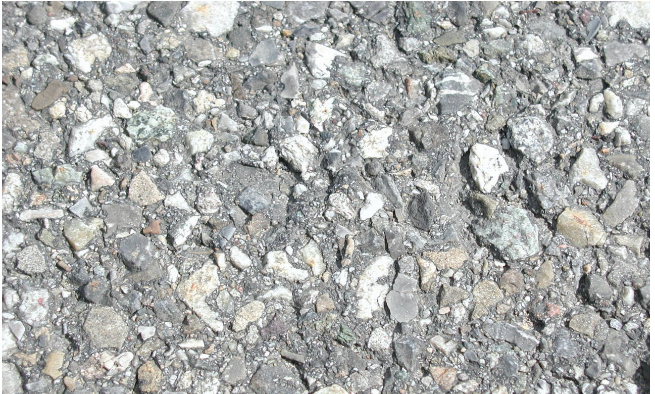
Fig. 11.1 : AB 16 dans l'agglomération de Schafisheim présentant un mastic altéré prématurément. Les granulats ne présentent pas de dégradations dues aux intempéries. Par contre le mortier présente une altération de moyenne importance.
