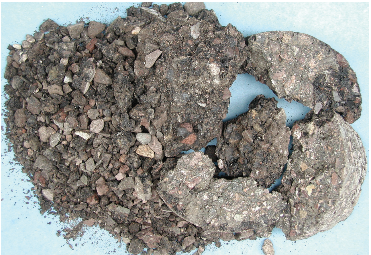
Fig. 11.4: état de la carotte prélevée dans l'enrobé dégradé de la RJ 18 dans le canton de Berne à la hauteur de la Chaux d'Abel. Le mortier bitumineux est totalement désagrégé.
