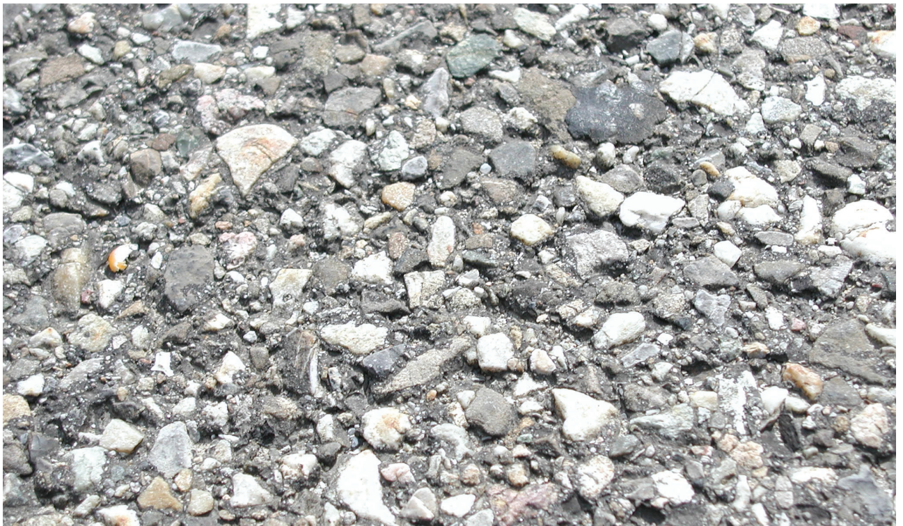
Fig. 11.2 : village de Gränichen. Enrobé AB 11 présentant un mastic avec des dégradations avancées et des phénomènes de desenrobage. L'âge du revêtement se situe entre 8 et 15 ans. Les granulats ne montrent pas de dégradation particulière et seul le mortier est touché.
