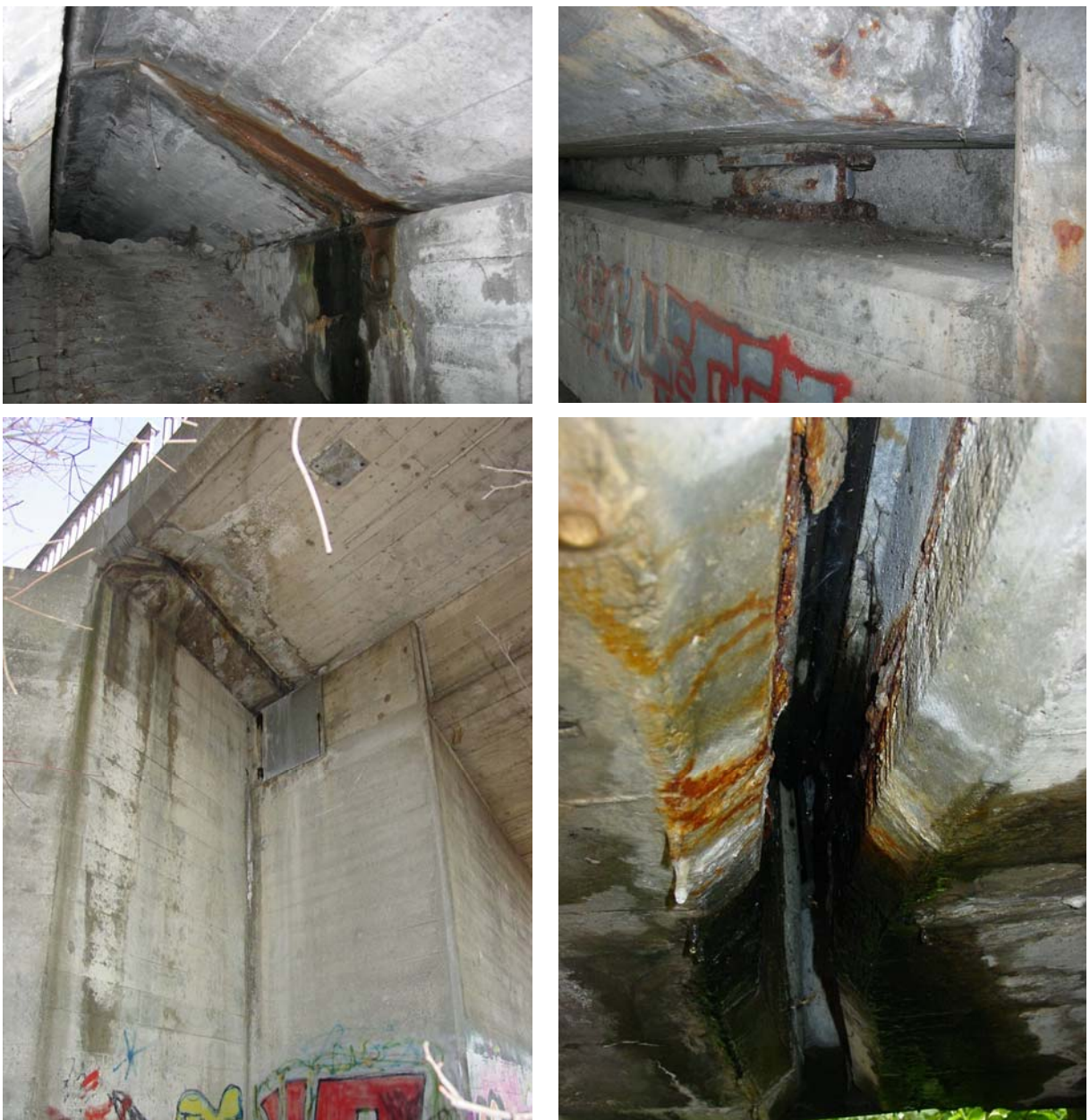
Bild 1 – Beispiele für durchnässte Widerlager infolge undichter Fahrbahnübergänge und dadurch verursachte Folgeschäden (Brücken des Nationalstrassennetzes vor der Instandsetzung).
