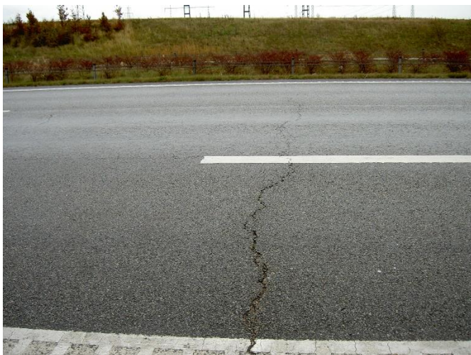
Figur 12. Tvärgående spricka vid inspektion hösten 2008. (Foto: Bengt-Åke Hultqvist).
