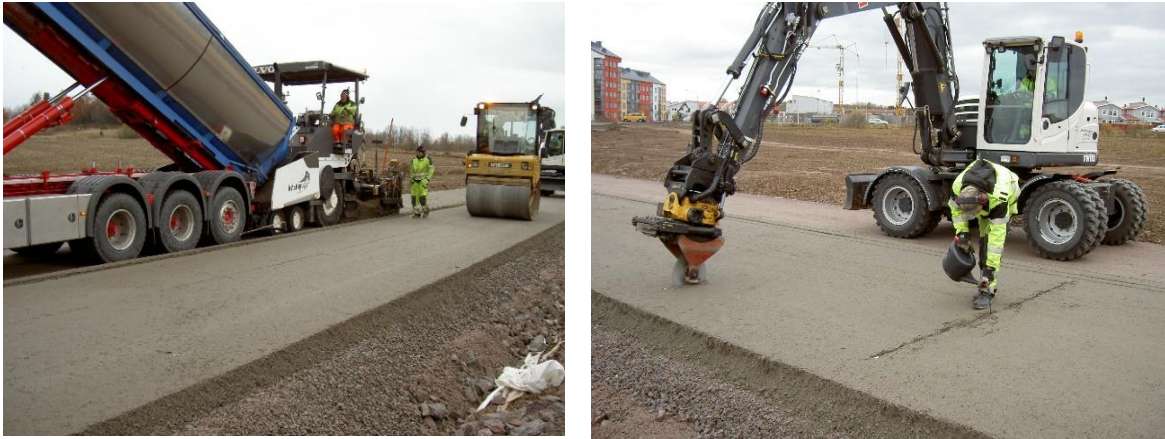
Figur 15. Vänster bild: Utläggning av CG med asfaltutläggare. Höger bild: Utförande av sprickanvisningar i CG-bärlagret. (Foto: Bengt-Åke Hultqvist).
