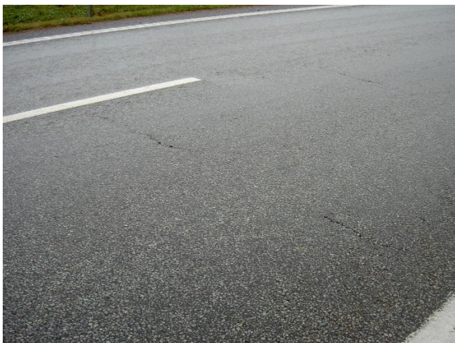
Figur 13. Tvärgående spricka på provsträckan vid inspektion hösten 2008. (Foto: Bengt-Åke Hultqvist).
