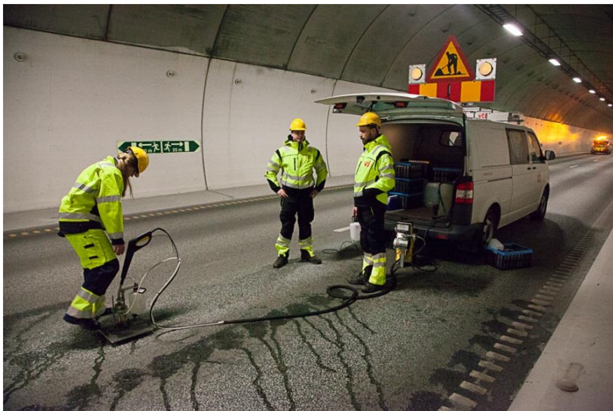
Figur 5. Provtagning i hjulspår i Strindheimstunellen. Restvatten i provpunkter från provytorna mellan hjulspår och vid väggkant ses också i bilden (Foto: Mats Gustafsson, VTI).
