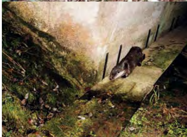
Вигра, преминаваща по пътека в дренажна тръба в република Чехия Otter using a walkway in a culvert in the Czech Republic
