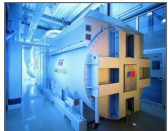
"HOT Module": Vattenfall forsøger med denne brændselscelle at forsyne både strøm og varme til en boligblok i den nye bydel i Hamburg "HafenCity"
